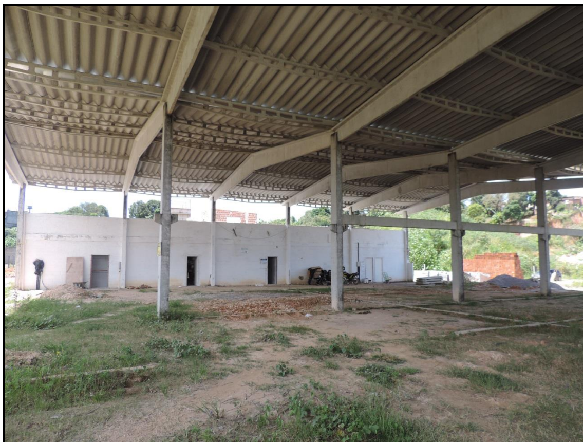
Figura 3.10. Central de Triagem em construção no município de Jaboatão dos Guararapes. Foto: CARUSO JR., 2014.
