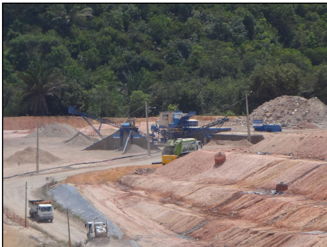
Figura 4.9. Unidade de recebimento de resíduos da construção civil na Central de Tratamento de Resíduos Candeias, município de Jaboatão dos Guararapes/PE. Foto: CARUSO JR., 2012.
